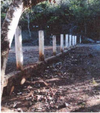
FOTO 1: Se observa el muro perimetral actual en mal estado
